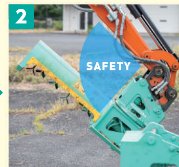
2 落下防止の角度センサーで安全
